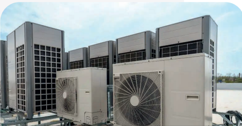
Sistemas de Ventilación
